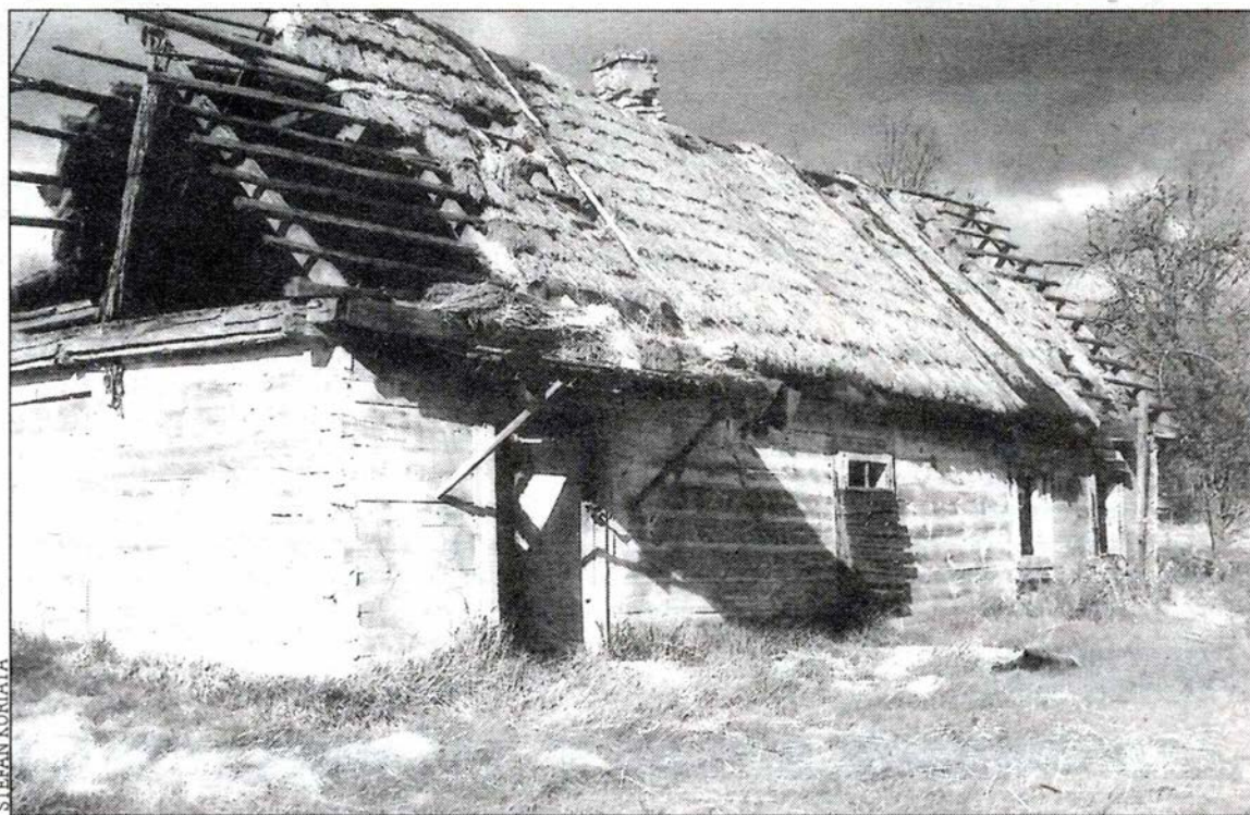
To wszystko, co pozostało po 800 zagrodach - wieś Huta Lubarska w rejonie baraniwskim, 2008 r.
