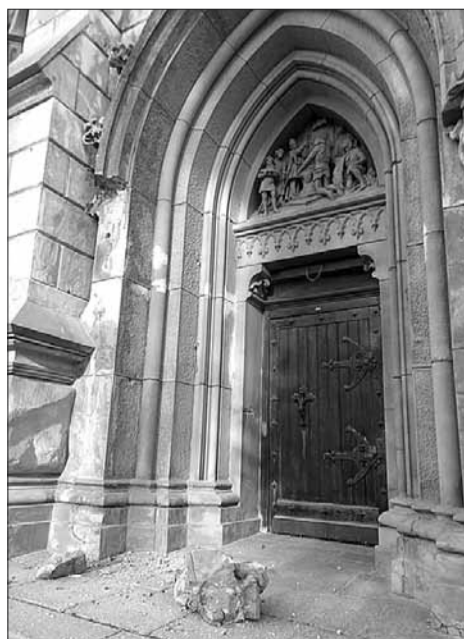
Niebezpieczna niespodzianka – niemal 100 kilogramowy fragment elementu zdobniczego zewnętrznej elewacji budynku przed frontonem świątyni
